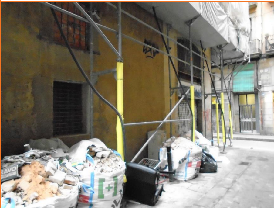
Foto 1. Vista exterior de l'edifici afectat a l'encreuament dels carrers Sant Antoni Abat (fons a la dreta de la fotografia) i carrer de la Cendra.
