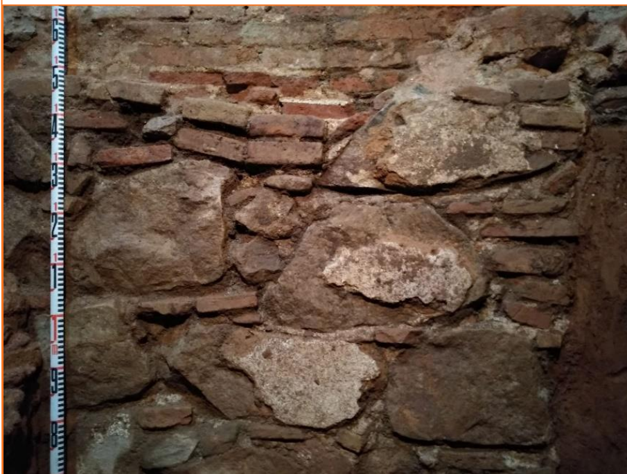
Foto 10. Detall de la fonamentació UE 10 afectada per la construcció de la reforma UE 9.
