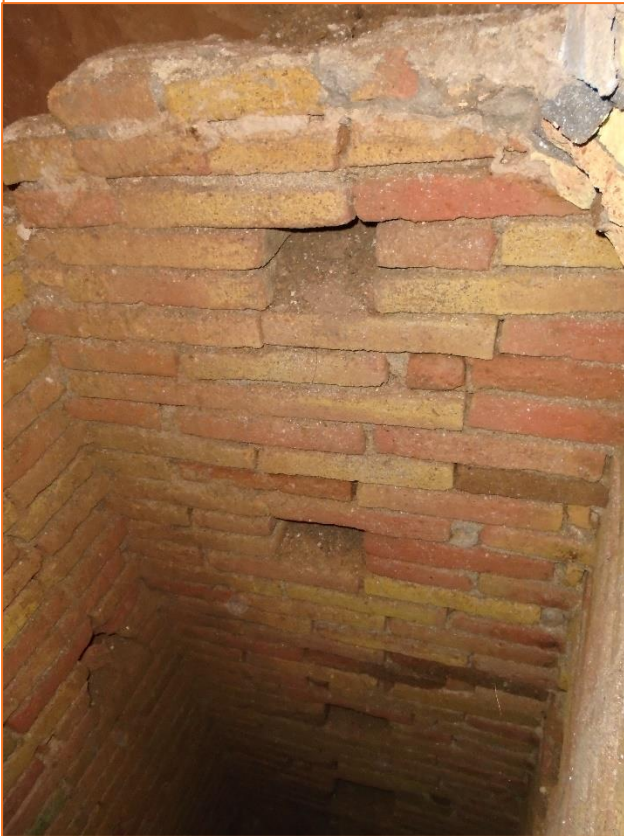
Foto 5. Vista de l'alçat interior nord del pou UE 3, un cop repicada la volta, amb els encaixos de l'escala de mà.
